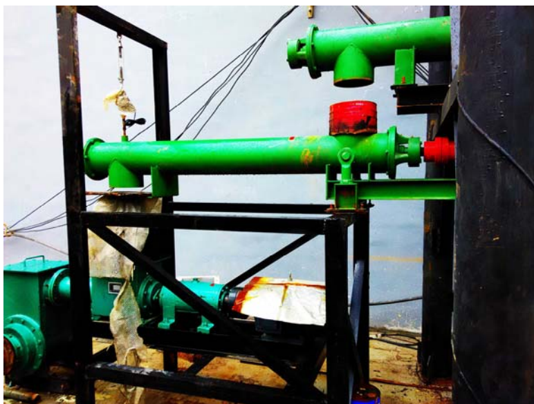
现场实物照片
